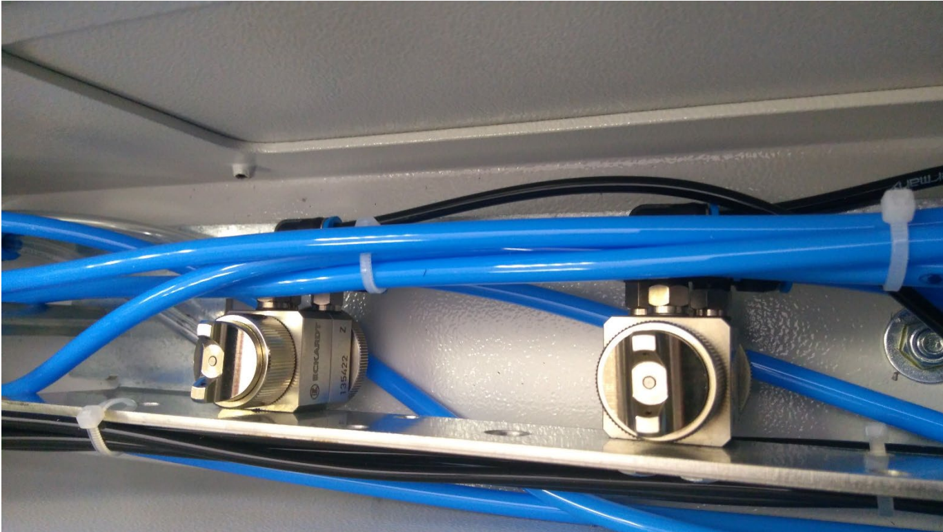
Sprühdüsen mit Versorgungsanschlüssen
