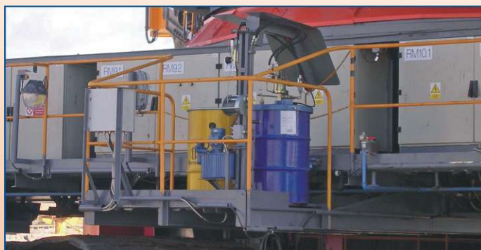
Station de pompes à fût
